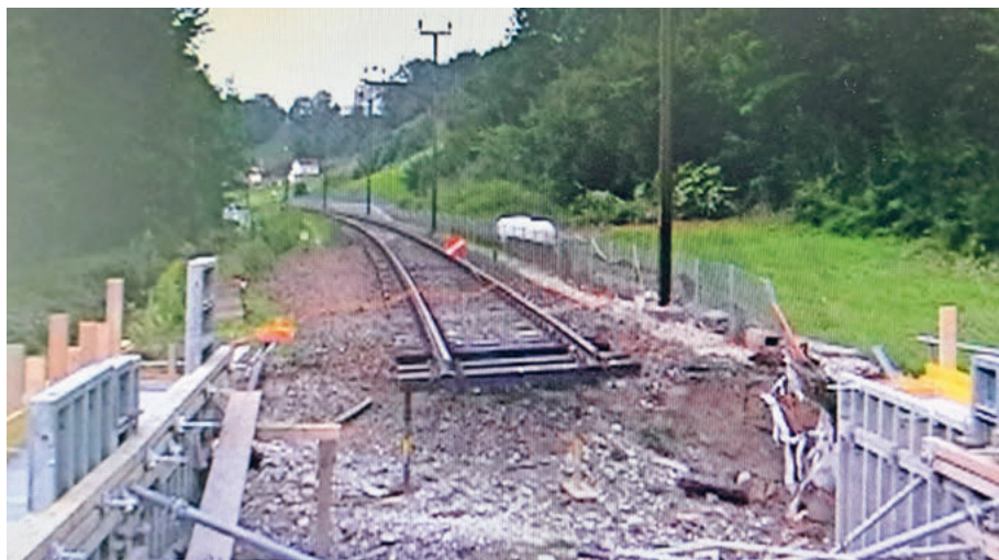
Littauerschachen: Unterbruch der SBB-Linie. Bild: zvg
